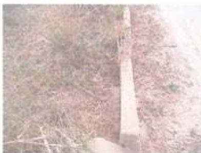
Foto 5 - Falta de escoramento dos meios-fios
