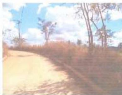
Foto 10 – Ondulações em grande parte da via
