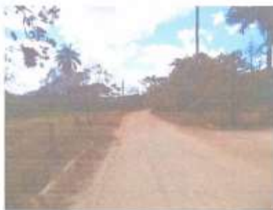
Foto 9 – Ondulações na via
