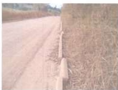
Foto 4 – Tombamento por batida / vandalismo
