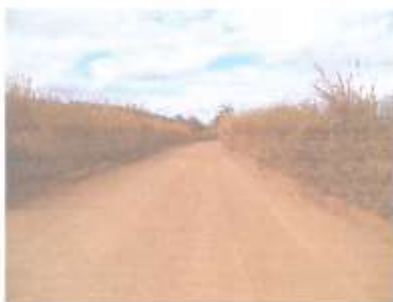
Foto 9 – Ondulações na via
