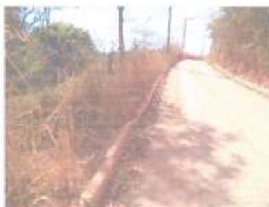
Foto 6 - Falta de escoramento/tombamento dos meios-fios
