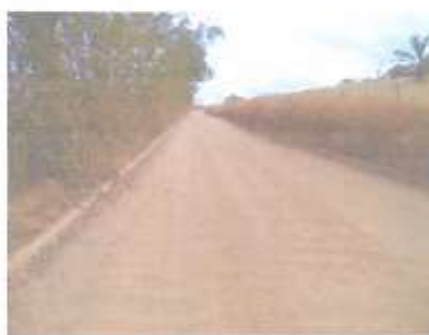
Foto 10 – Ondulações em grande parte da via
