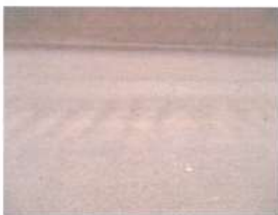
Foto 9 – Ondulações na via
