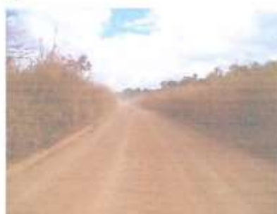
Foto 8 – Sarjeta/Escuramento seria executada no final da obra
